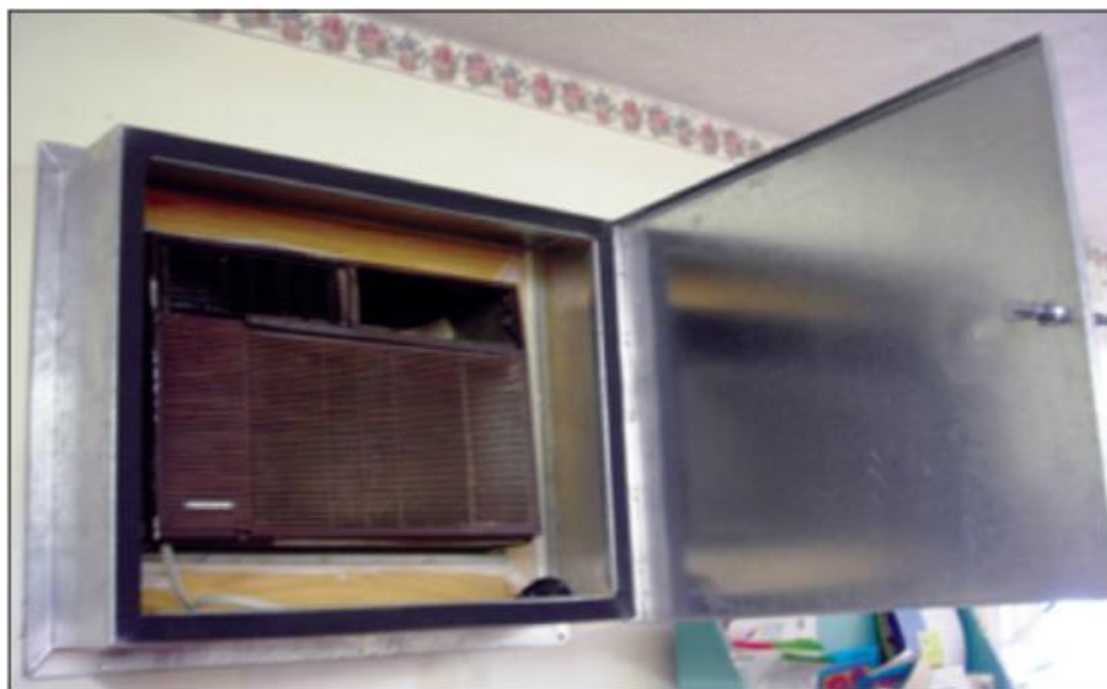
شکل ۳-۰. تعدیل‌کننده دستی برای هوابندی تهویه مطبوع در یک اتاق امن
