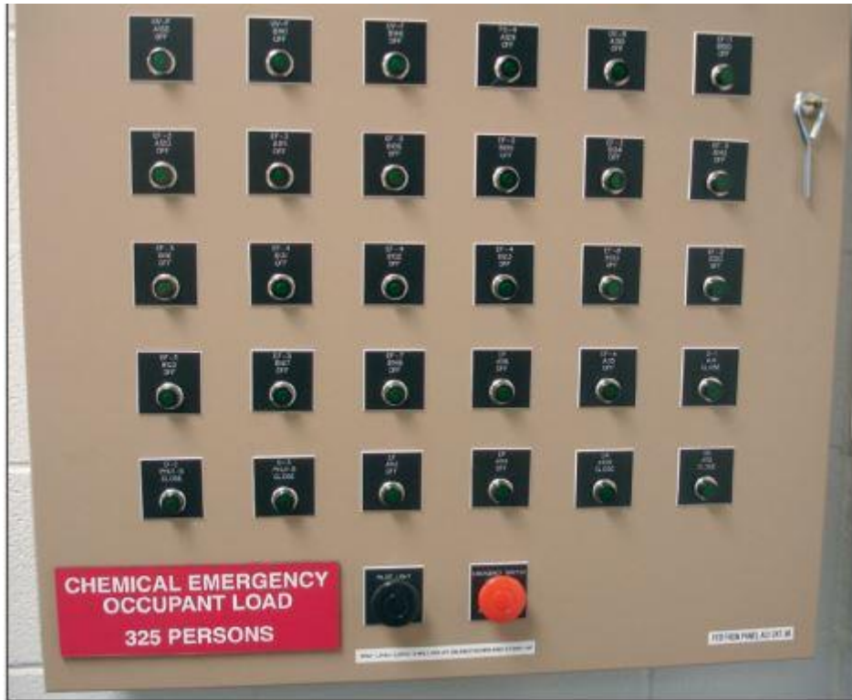
شکل ۴-۰. یک پنل کنترل پناهگاه در یک مدرسه با یک کلید خاموش کردن فن (کلید فشاری قرمز در مرکز پایین) و چراغ‌های نشانگر وضعیت دمپرها و فن‌ها
